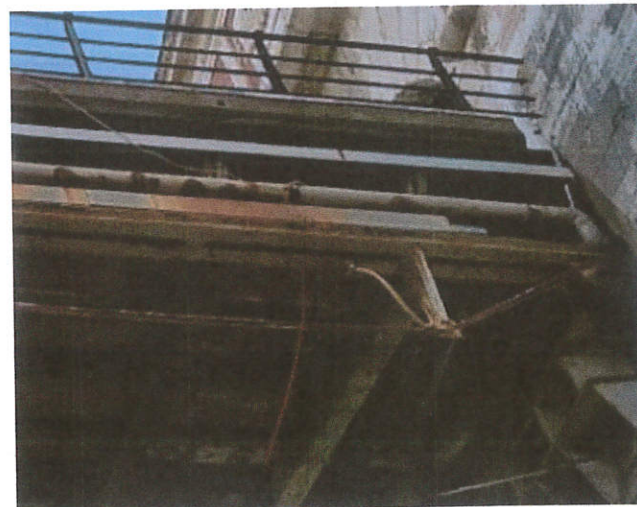
Εικόνα 49 : τα κανάλια διέλευσης των ηλεκτρομηχανολογικών αγωγών στη νότια πλευρά της γέφυρας.
